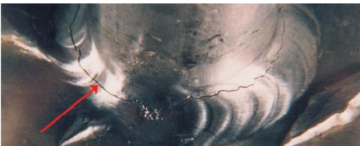
Figura 26. Grieta Longitudinal Propagada por Una Grieta de Cráter
